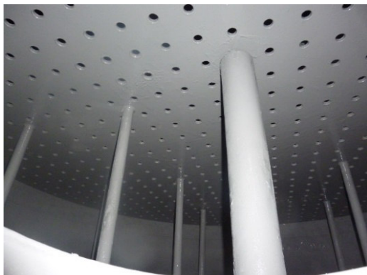
Innenraum des Oxidators
