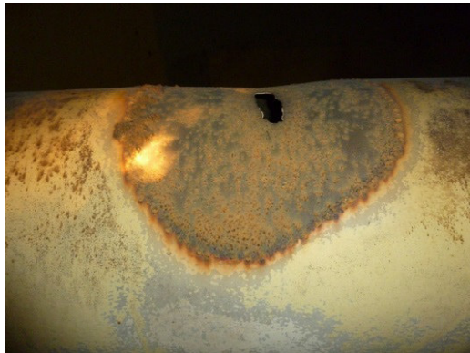
Schaden an der Verrohrung im Inneren eines Filters
