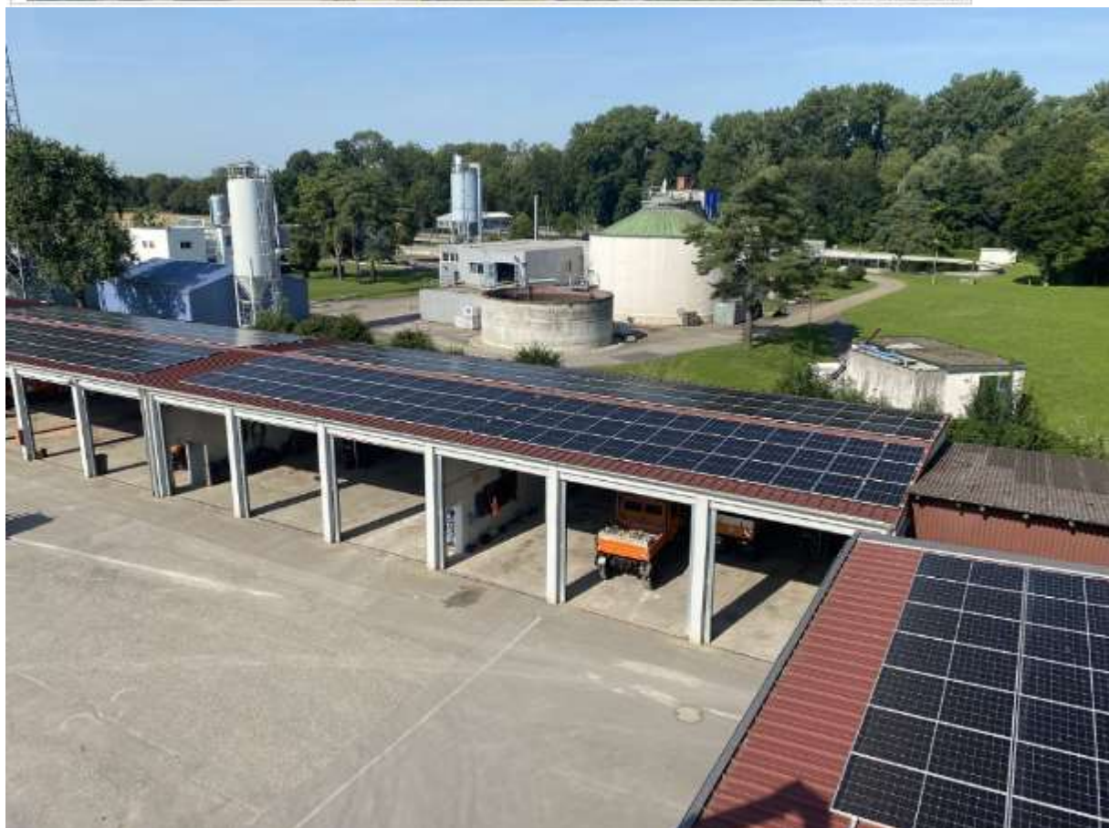
Foto PV- Anlage
